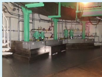
導入された コリウムシールド
